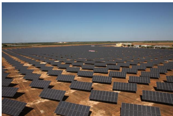
Planta de energía solar en Torre Santa Susanna, Italia
